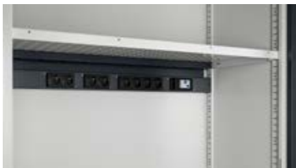
Zastosowanie korytka elektrycznego w dolnej części półki-panelu z otworami
