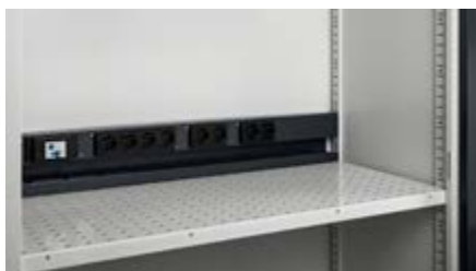
Anbringung des Energiekanals im oberen Bereich des Lochbodens/der Lochplatte
